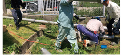
仮設管は4メートル、基本的にふたりで運ぶ。単管を切断する。作業しやすいように足で押さえる。
